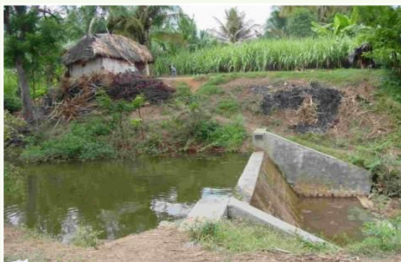
คันชะลอความเร็วของน้ำที่สร้างด้วยคอนกรีต
