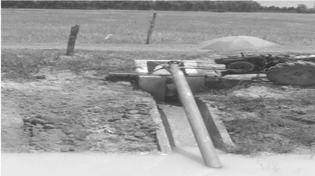
ท่อระบายน้ำเข้า-ออกจากแปลงนา
