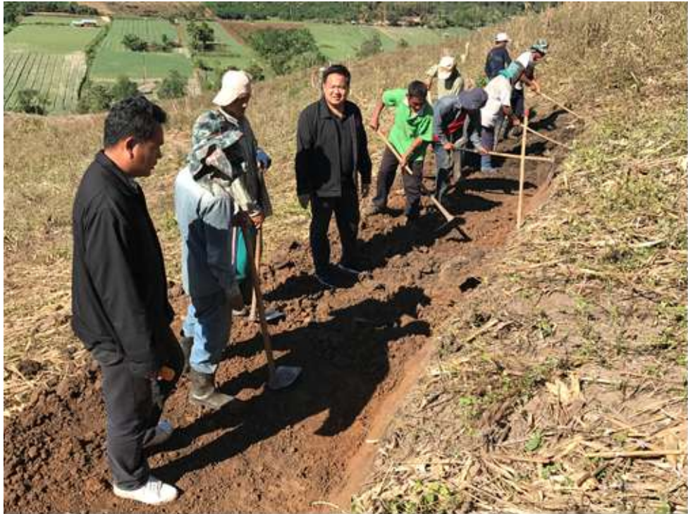
ภาพที่ 22 ดูแลและควบคุมการดำเนินการคันคูรับน้ำขอบเขา (คันดินแบบที่ 5)
