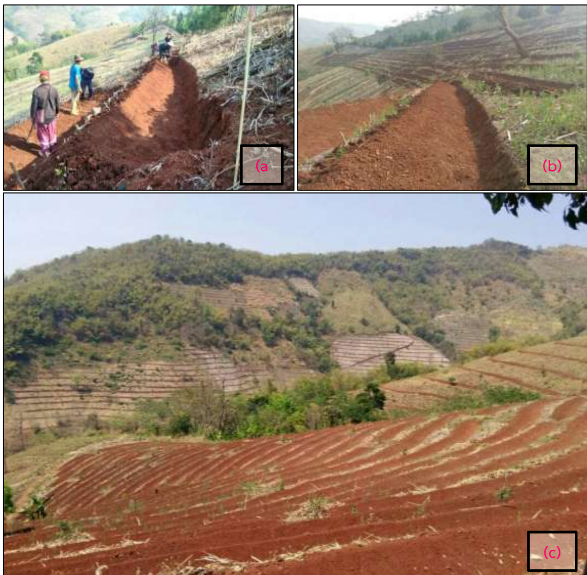
ภาพที่ 12 การก่อสร้างชั้นบันไดดิน ใช้แรงงานคนในการขุด (a) ระยะห่างของแต่ละคัน และลักษณะการตัดหน้าดินเมื่อขุดเสร็จแล้ว (b-c)
